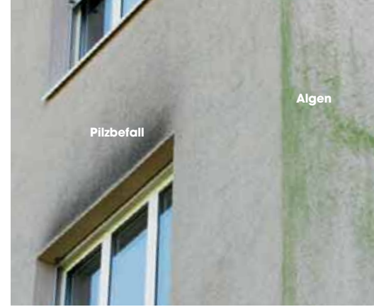
Algen und Pilze an der Fassadenoberfläche
